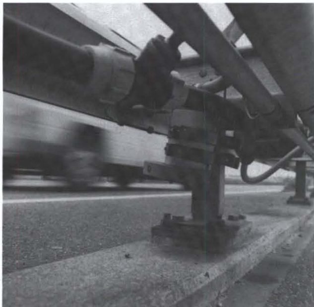
Een automatische zoutstrooier op de IJsselbrug bij Kampen
