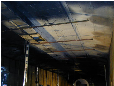
Figuur 5.11 Sprinklerleidingen aan tunnelplafond
