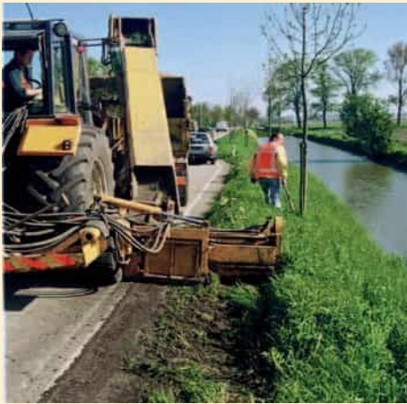
Grond van onvoldoende kwaliteit (bijvoorbeeld afkomstig van bermverlaging) gaat naar een erkende verwerker. Foto Beppie van den Hengel.
