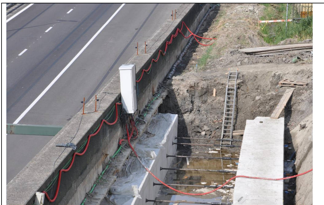
Verankering om de wanden van de Vlaketunnel aan de bovenzijde vast te zetten en daardoor alsnog bestand te maken tegen het 'opspaneffect'.
