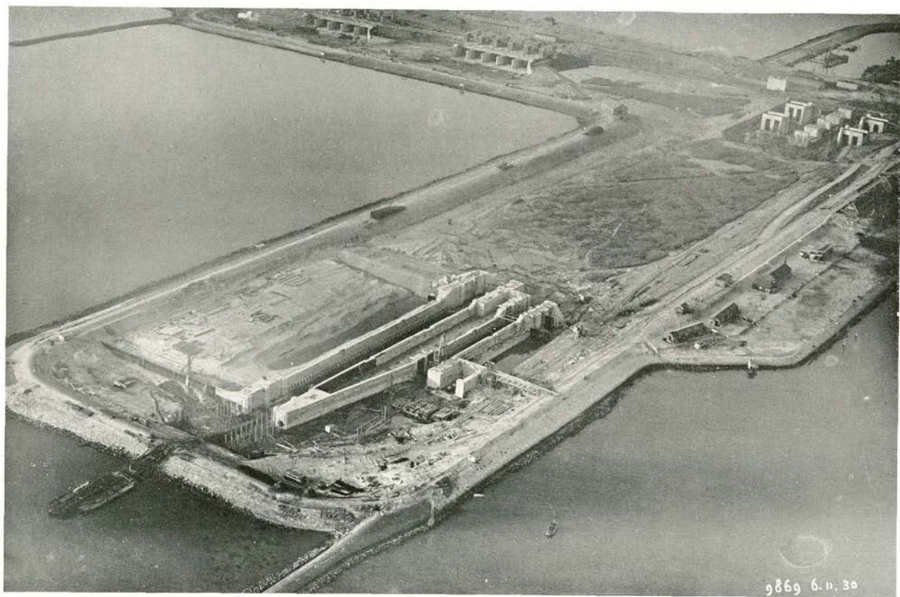
Nº. 2. Overzicht van den bouwput op het Kornwerderzand, gezien uit het Zuidoosten. Op voorgrond: groote en kleine schutsluis met droogdokje naast het binnenhoofd van de laatste. Op achtergrond: links twee complexen elk van vijf uitwateringssluizen, rechts onderbouw
