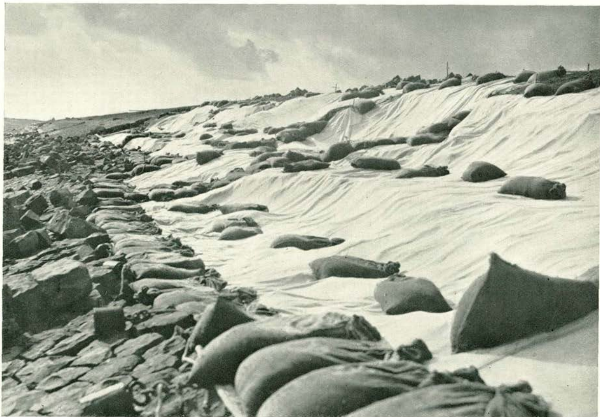
N o . 1. Voorloopige voorziening van de gaten in het binnenbeloop van den Afsluitdijk met zeilen en zandzakken.
