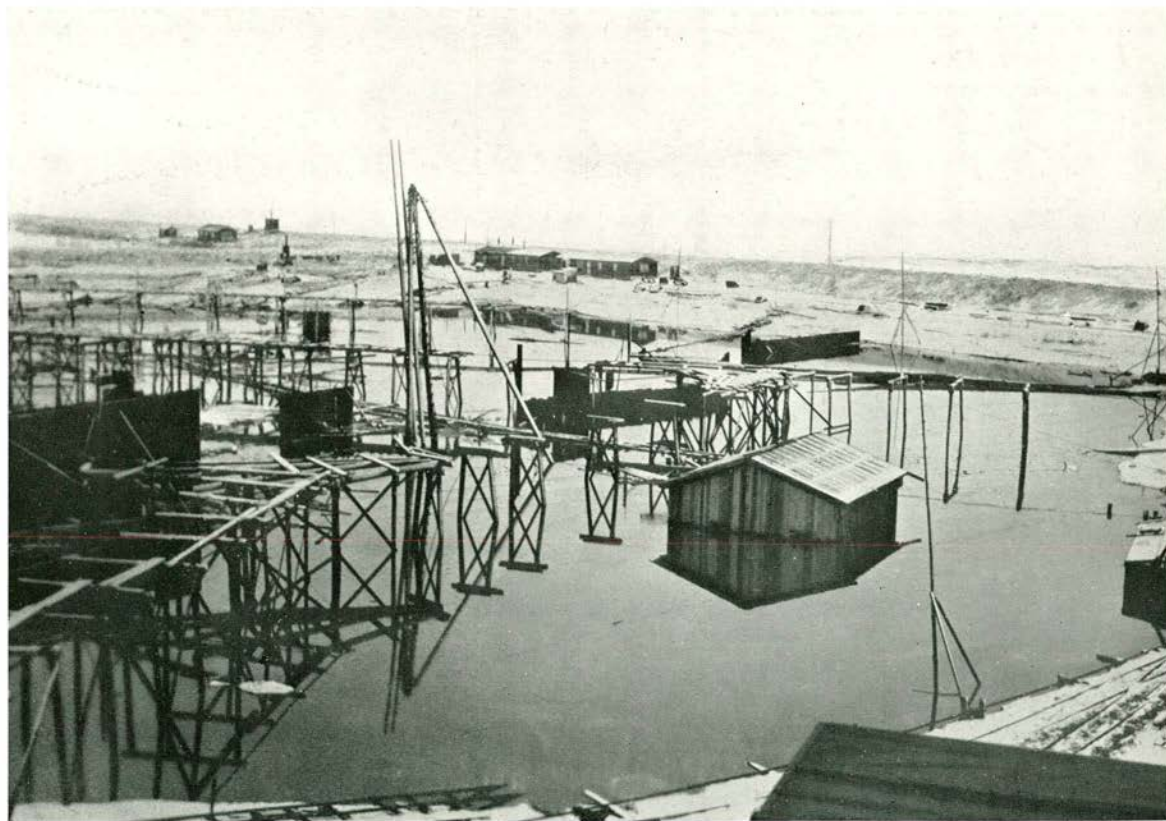
N o . 2. Gezicht in den fundeeringsput te Urk, nadat het water tot boven de in uitvoering zijnde werken was gestegen. Op den voorgrond het eenige niet verbrande pomplokaal (23 December 1939).
