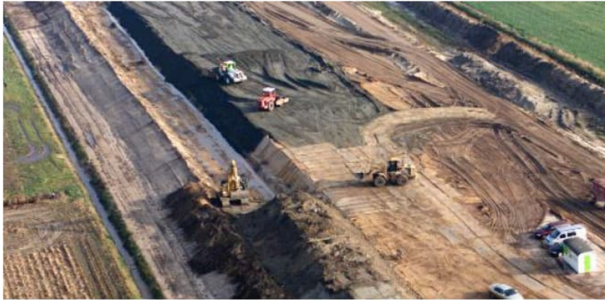
Figuur 27 Zandbaan tussen de Leijgraaf en viaduct Hoogstraat (bron: beeldbank RWS, ID269471, 20 november 2002, )
