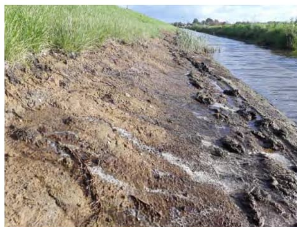
Figuur 2.4: foto met lekkage uit talud aanberming
