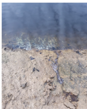
Figuur 4.4: foto met lekkage uit talud aanberming
