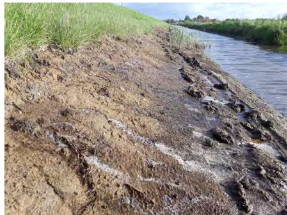
Figuur 4.4: foto met lekkage uit talud aanberming
