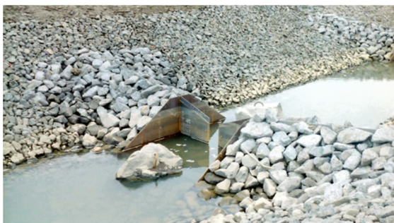
Figuur 4 Drempel in de vispassage van stuw Hagestein tijdens de aanleg (Schropp, 2011)
