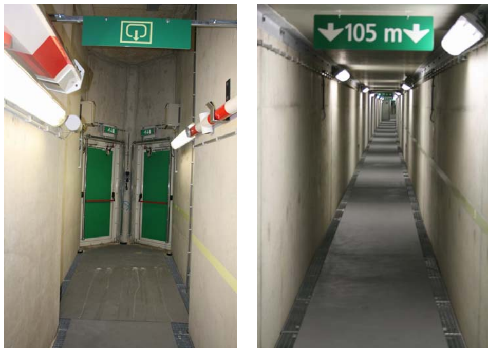
Figuur 3: Middentunnelkanaal Wijkertunnel met kopdeuren aan noordzijde
