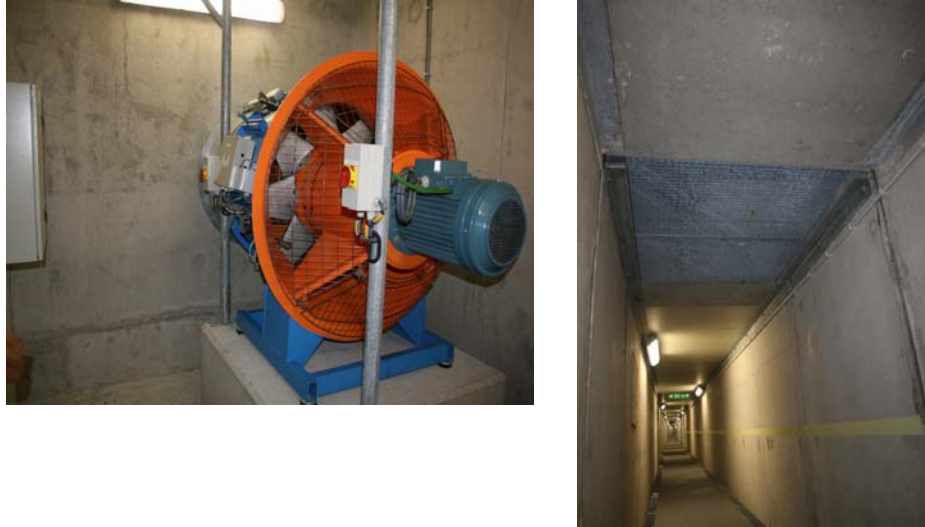
Figuur 4: Overdrukventilator met inblaasrooster in middentunnelkanaal
