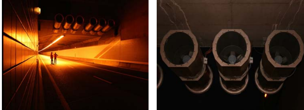
Figuur 1: Tunnelventilatoren in Wijkertunnel
