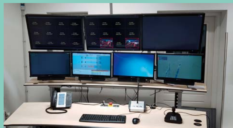
De nieuwe werkplek voor de sluismeesters van de Beatrixsluis.
