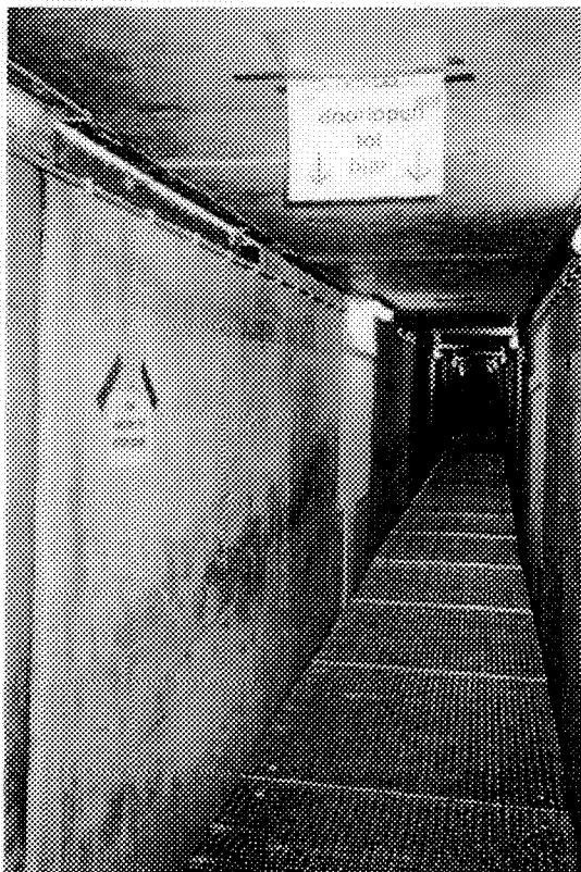
Fig. 21 Gebrek aan informatie in het vluchtkanaal. De borden aan het plafond en aan de wand waren alleen voor de proeven aangebracht.
