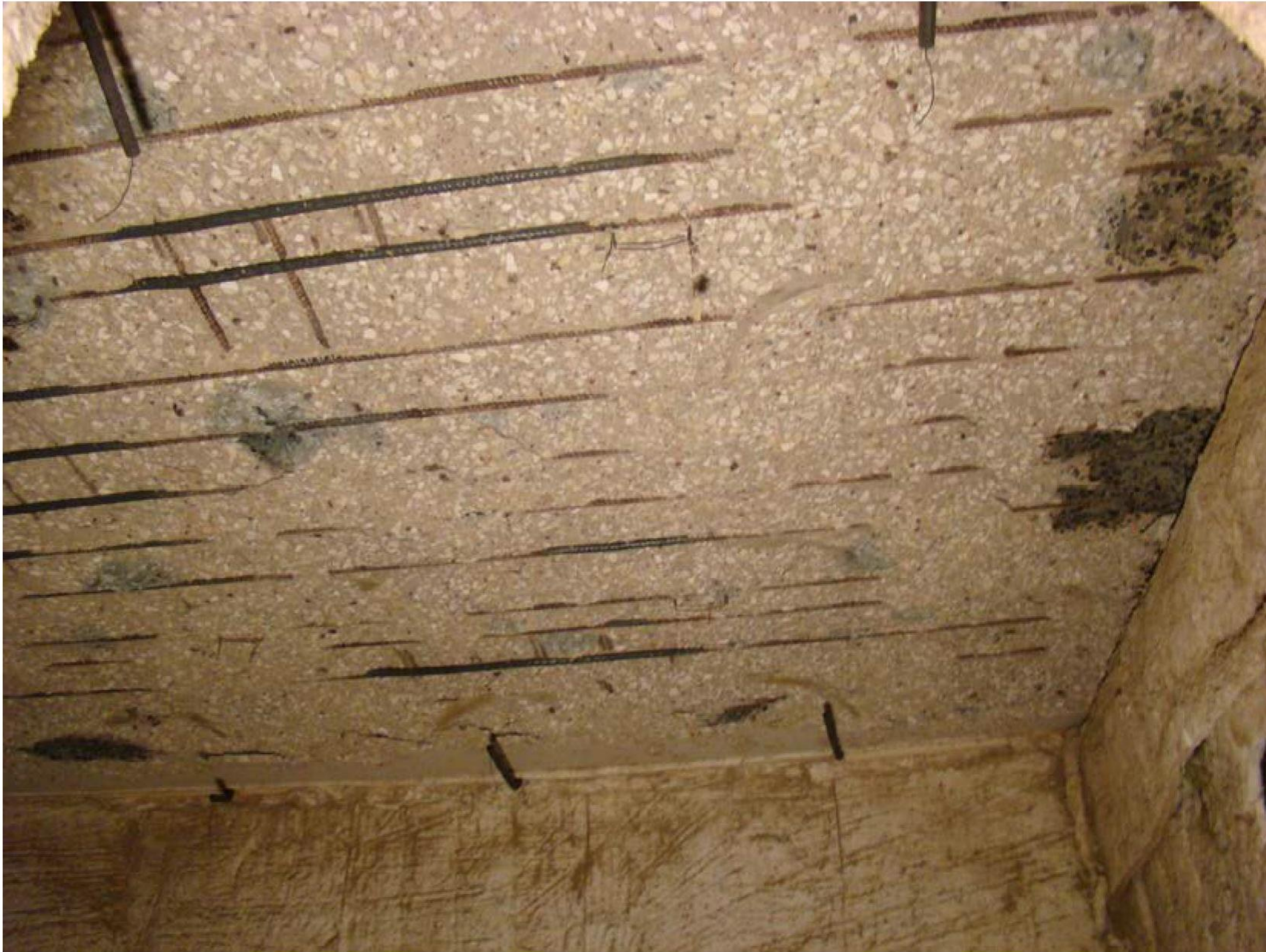
Foto 3: Verhit oppervlak na de brandproef
