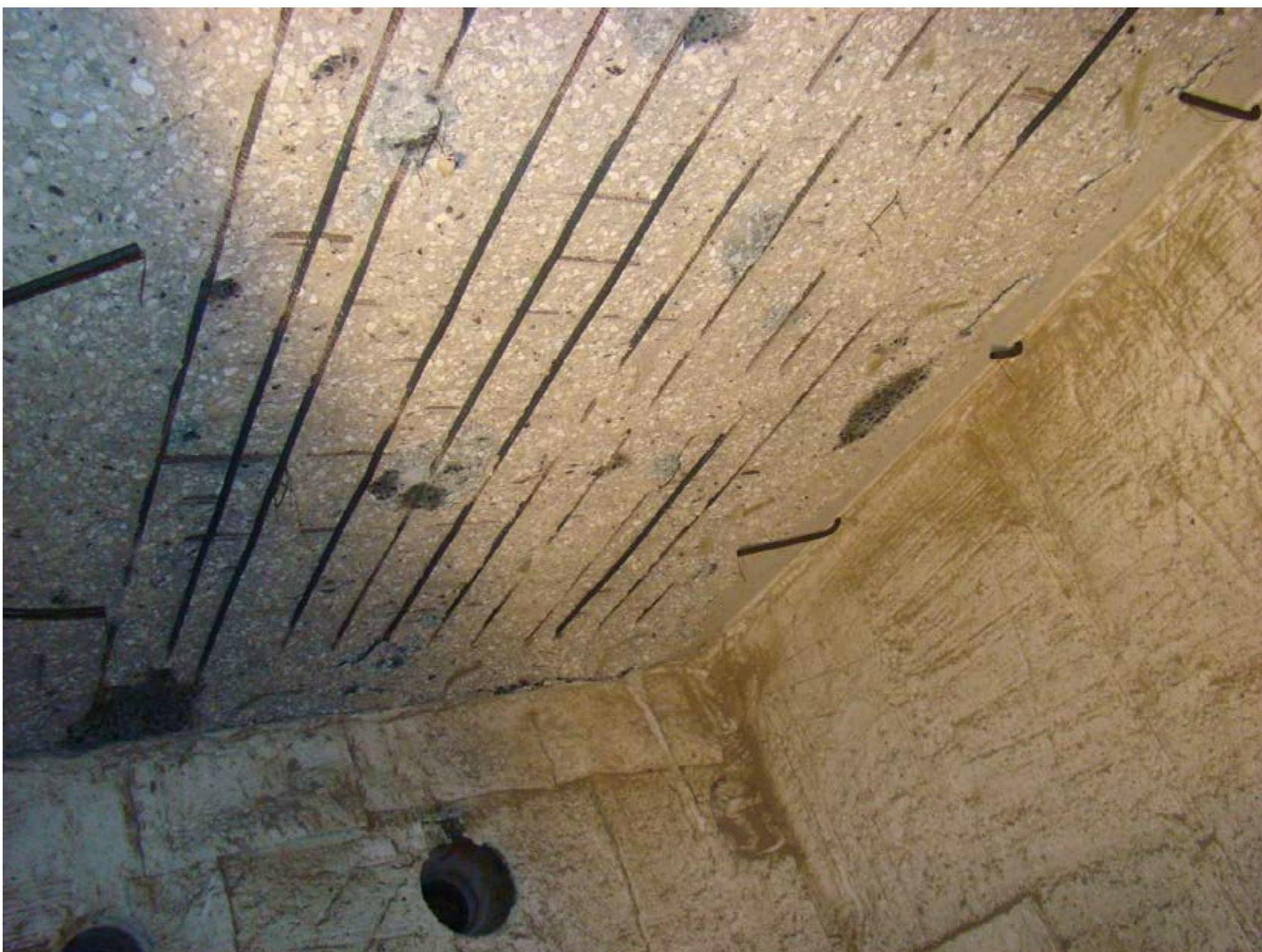
Foto 4: Verhit oppervlak na de brandproef
