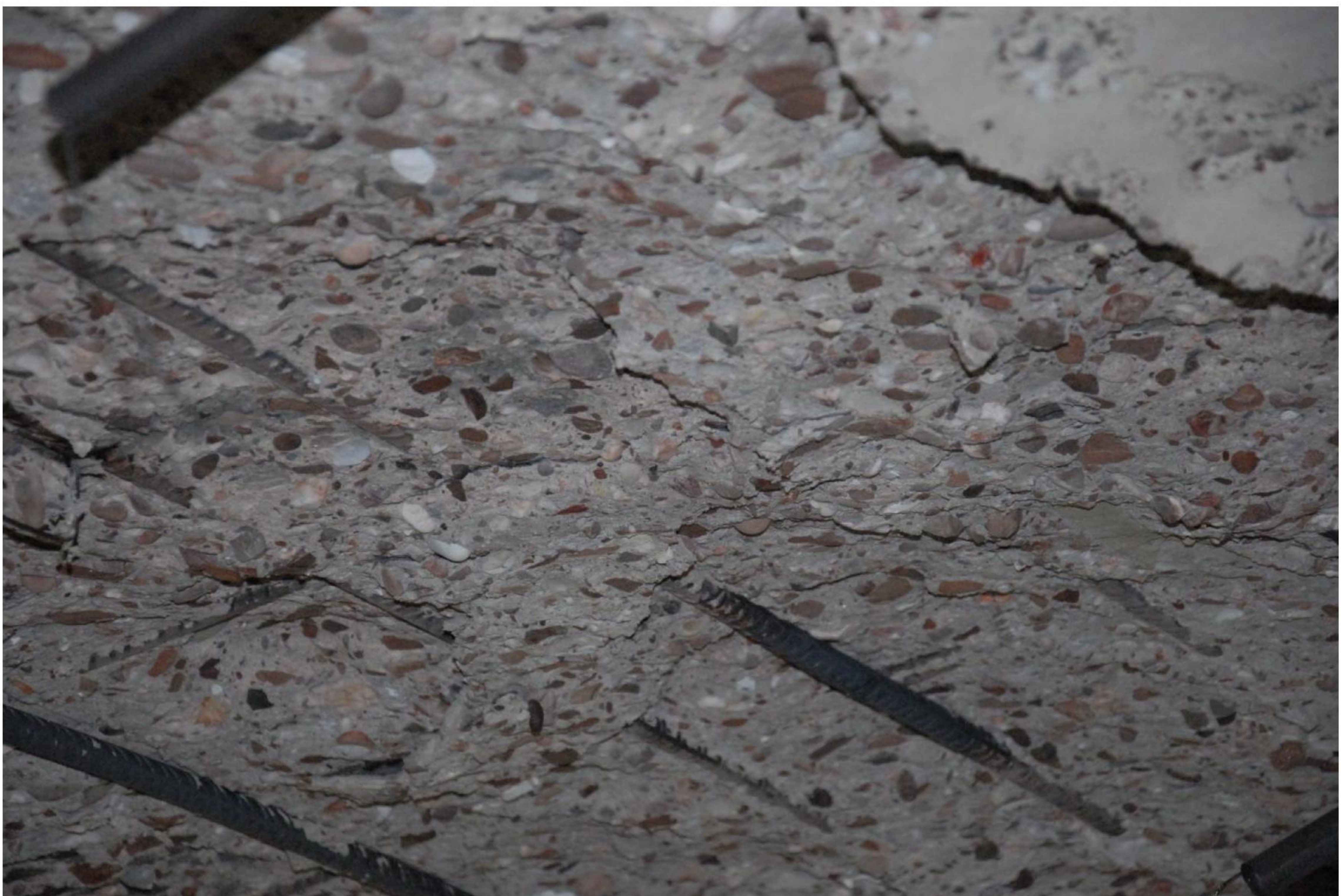
Foto 6: Details van het verhitte oppervlak na de brandproef
