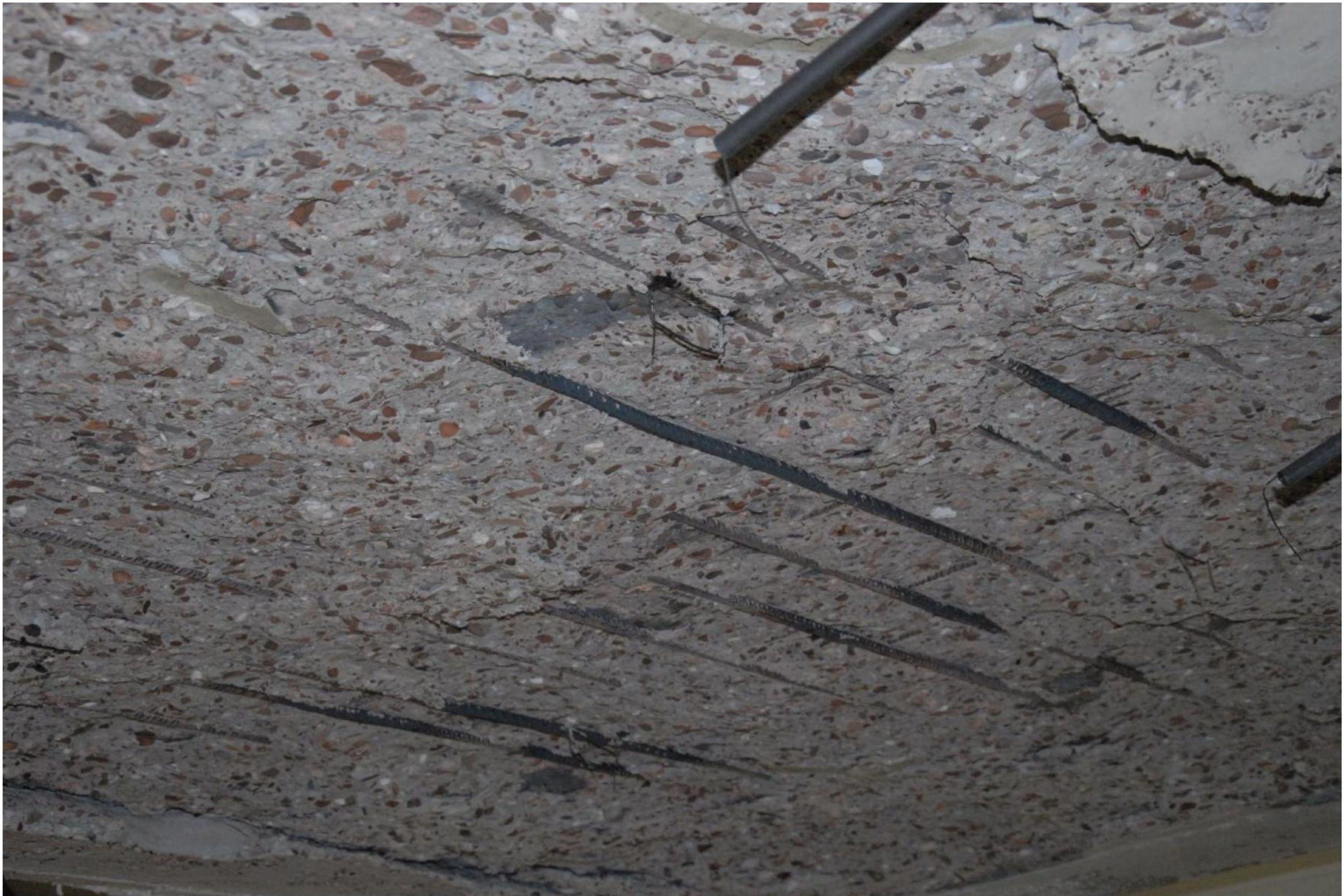
Foto 5: Details van het verhitte oppervlak na de brandproef
