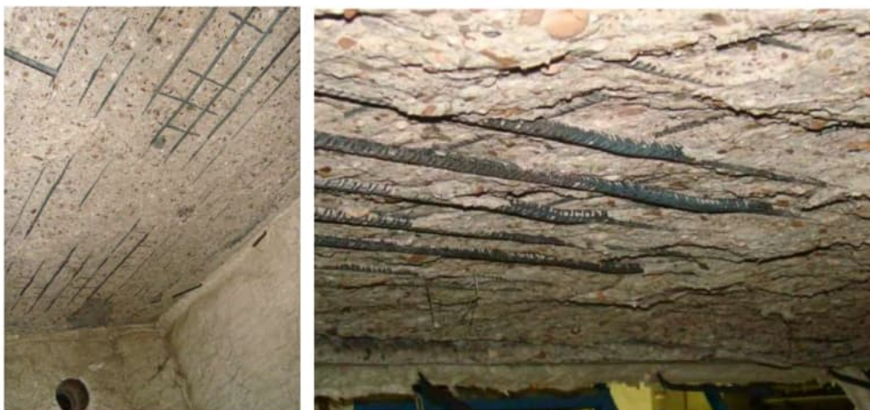
figuur 40 Foto’s van het verhit oppervlak na de brand gedurende 26 minuten (RWS Bramen brandproef 1 [81]).
