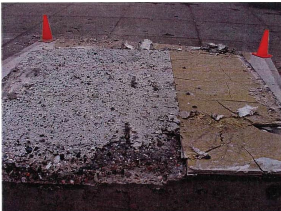
figuur 30 Overzicht van schade na afkoelen (alle tegels weg) [18].
