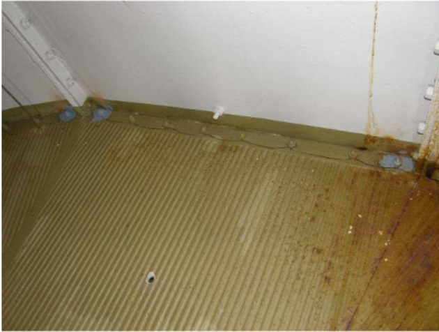
Gescheurde vloeren vanaf ca bouwlaag 12
