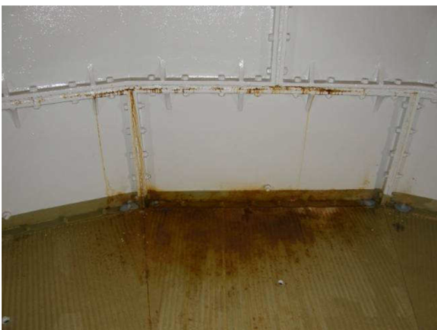
Lekkage vanuit de gevel. Roestende vloeren
