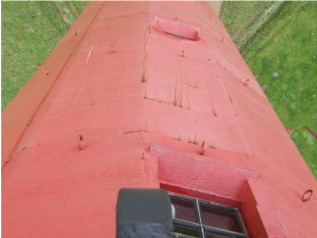
Plaatselijk roest Algemeen beginnende verkrijting
