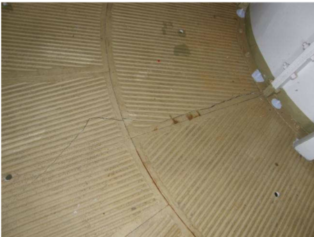
Gescheurde vloeren vanaf ca bouwlaag 12
