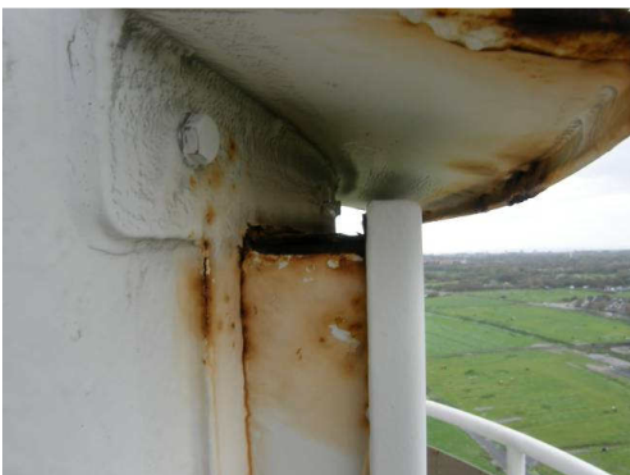
Plaatselijk gevorderde roestvorming
