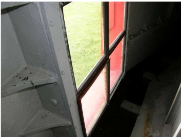
Gebreken en lekkage aan beglazingsrubbers
