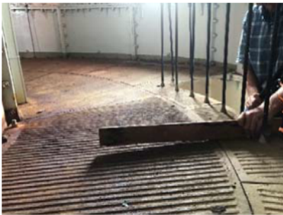
Foto 6: Zichtbaar scheve vloer
