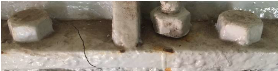
Foto 2, scheurvorming wandpaneel (binnenzijde van buitengevel)
