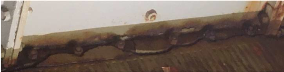
Foto 1, scheurvorming vloer nabij buitenwand
