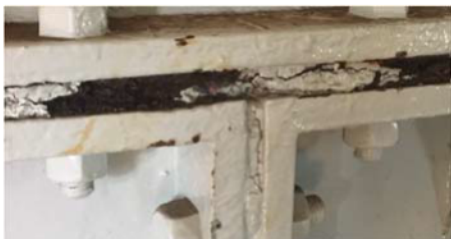
Foto 4, aantasting van ijzercementvoegen
