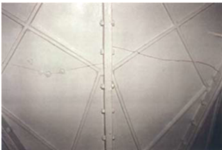
Foto 3, scheurvorming vloer (v.a. onderzijde)
