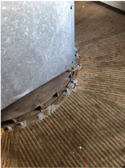
Foto 5: Vloer los van de binnenschacht
