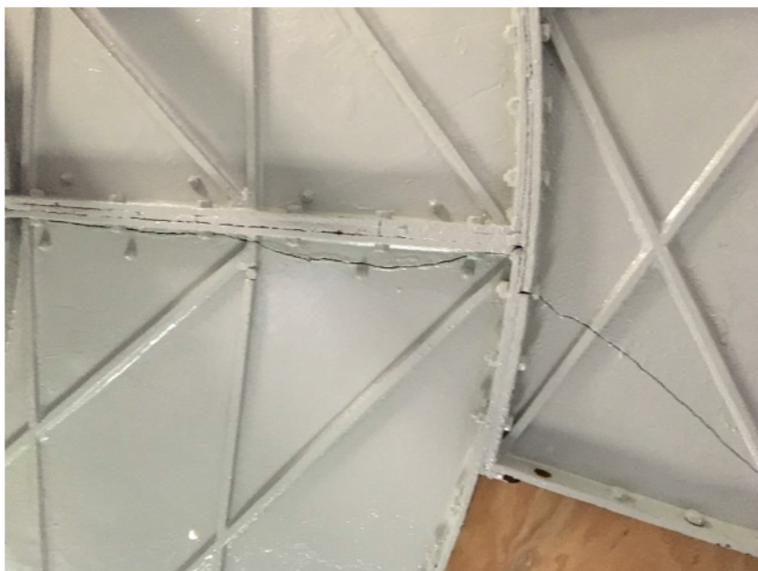
Figuur 1: scheur door vloerplaten heen
