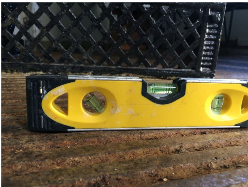
Figuur 5: schuinte van vloer met waterpas, ca. 8 cm over 2 m afstand
