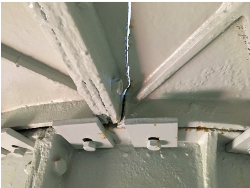
Figuur 3: scheurvorming bij "opleghandje" vloerplaat
