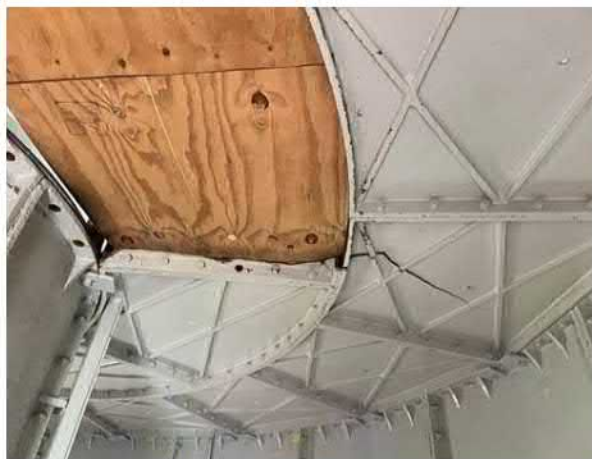
Figuur 4.3: Scheur in de vloer tijdens de rondgang
