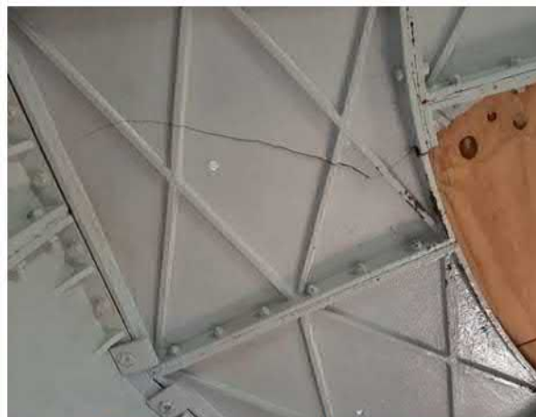
Figuur 4.4: Scheur in vloer tijdens de inspectie
