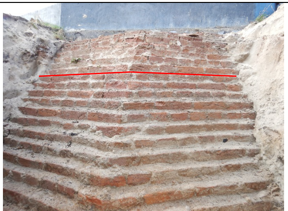
Figuur 9.5: Horizontale scheur door lintvoeg
