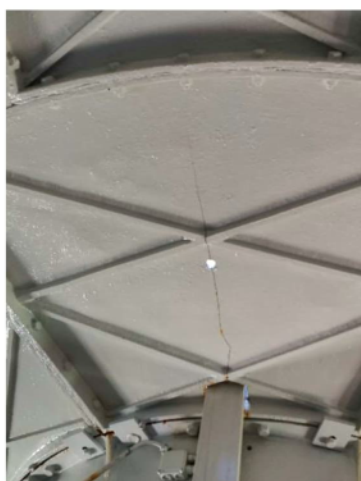
Foto 4: Scheuren in onderzijde vloer
