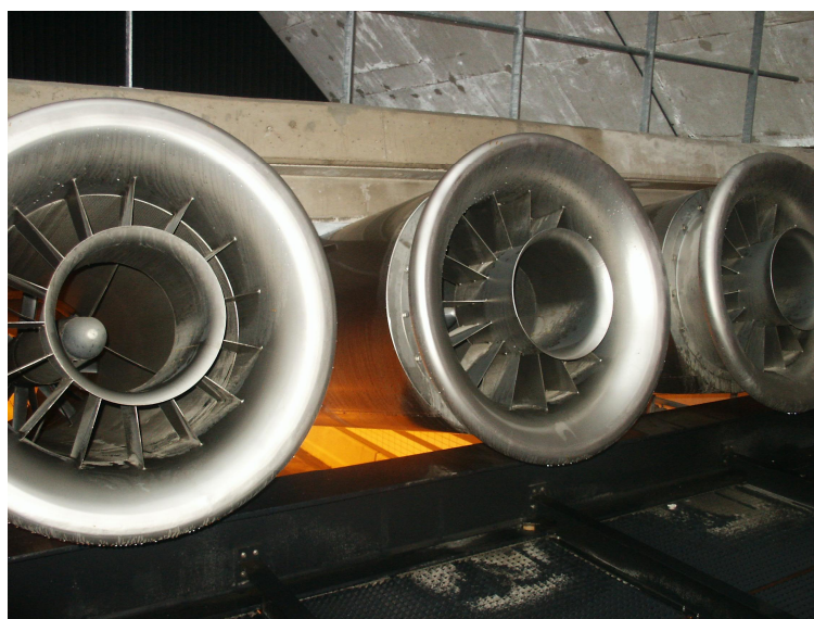
Figuur 4-13: Aanzuigconus ventilatoren in ingangsportaal – praktijksituatie
