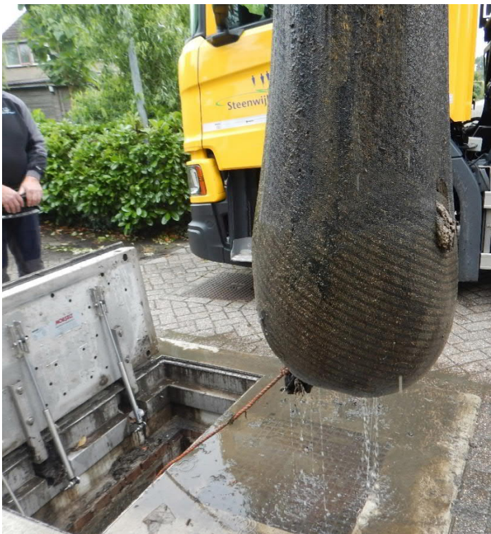
Figuur 4-1 Vuilfuik® lichting overstortput Steenwijkerland, Steenwijk. De gaten in de fuik zijn gemaakt tijdens het lichten uit de overstortput.
